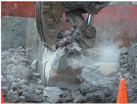
写真-8 梁破砕状況 (パクラー)
