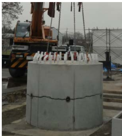
写真1 凍結膨張によるひび割れ状況
