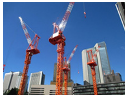
現場に設置されたタワークレーン
