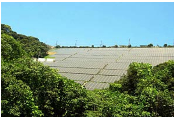
長崎さくらの里メガパワー発電所（2.1MW）
