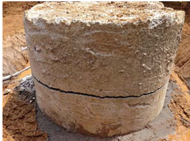
ひび割れ状況
