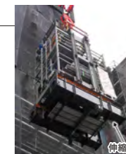
機械室ユニット
