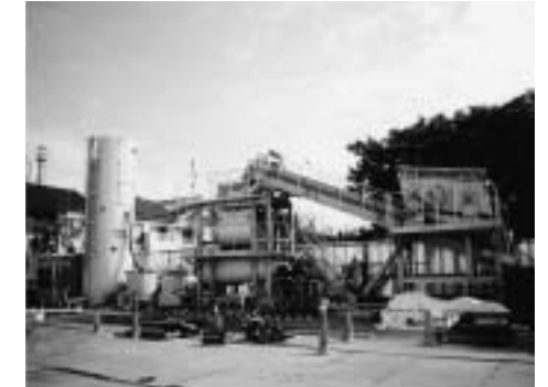
ソイルセメント生成プラント
