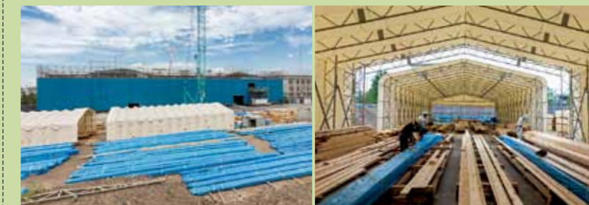
左:現場の全景。白いテントが製材スペース。| 右:製材スペースの内部。
