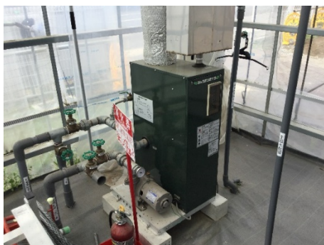
写真-6 温湯ボイラ (灯油炊き)
