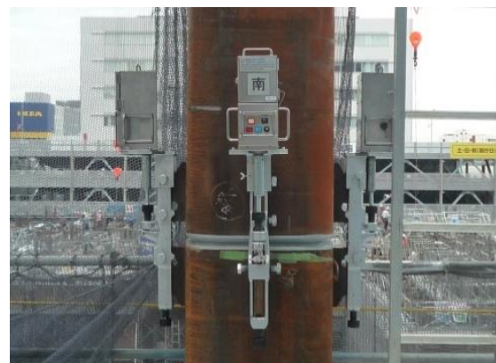
写真-4 自動建入れ制御機
