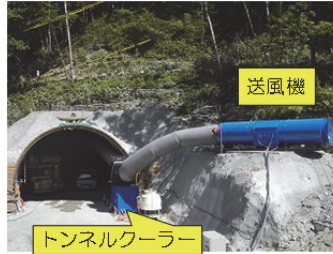
写真-2 送風機自動稼働状況 (H26. 8)
