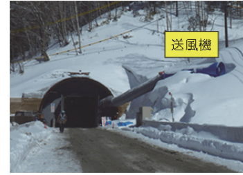
写真-3 送風機自動稼働状況 (H27. 3)
