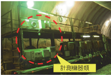
写真-4 自動計測状況 (計測機器全景)
