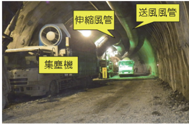
写真-1 集塵機自動稼働状況
