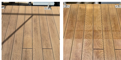
図10 晴天時(乾燥状態)と降雨後のウッドデッキ
