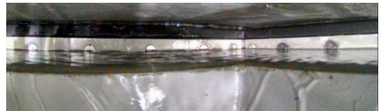
写真A5 試験体①Cの漏水状況
