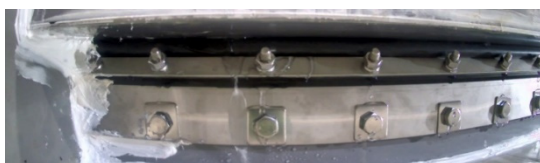
写真A3 試験体③Sの漏水状況
