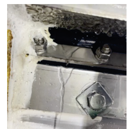
写真11 Pゴム端部の漏水
