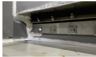
写真5 Pゴム端部
