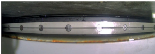
写真A1 試験体①Sの漏水状況
