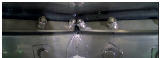
写真A7 試験体③Cの漏水状況
