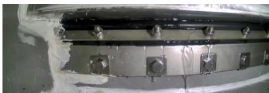
写真A4 試験体④Sの漏水状況
