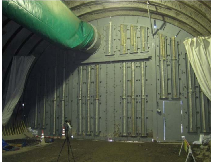
写真1 山岳トンネルの坑口に設置された新発想の「剛性付加式防音扉」
