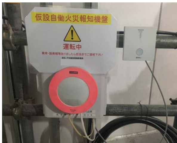
写真-2 単管パイプに設置した光る警報ブザーと中継アダプタ
