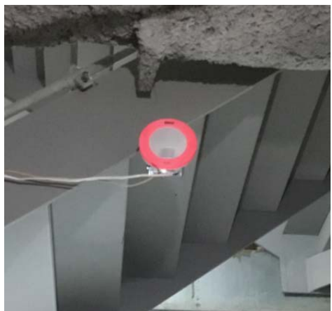
写真-3 階段のササラを利用した光る警報ブザーの設置状況
