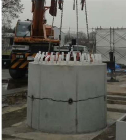
写真1 凍結膨張によるひび割れ状況
