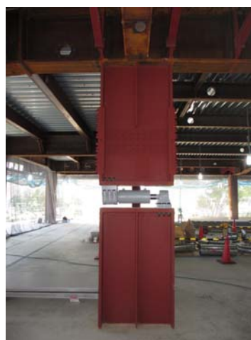
写真2 間柱ダンパー
